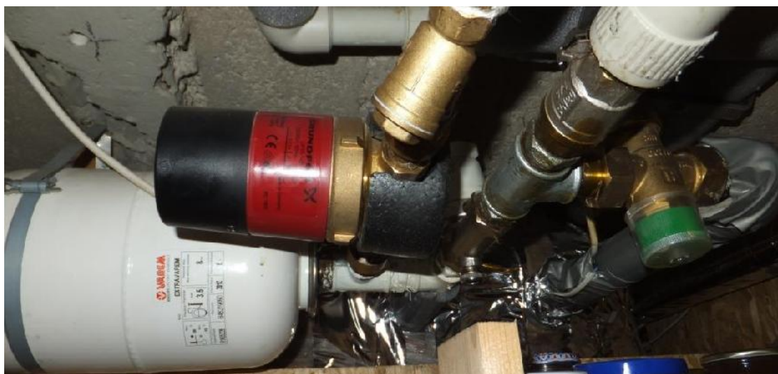
Obehové čerpadlo TV so zmiešavacím ventilom chrániacim pred oparením
