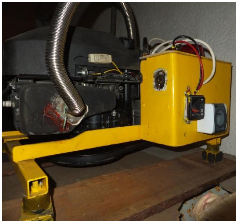
Benzínová elektrocentrála s antikorovým výfukom vedúcim do dymovodu. Kvôli bezpečnosti sa štartuje manuálne
