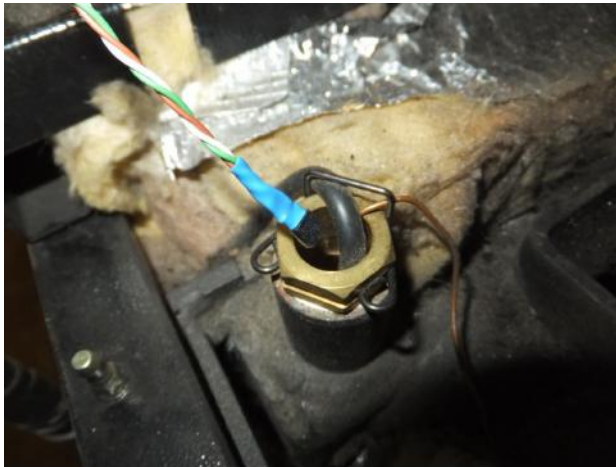
DS18B20 meranie teploty vody na výstupe z kotla
